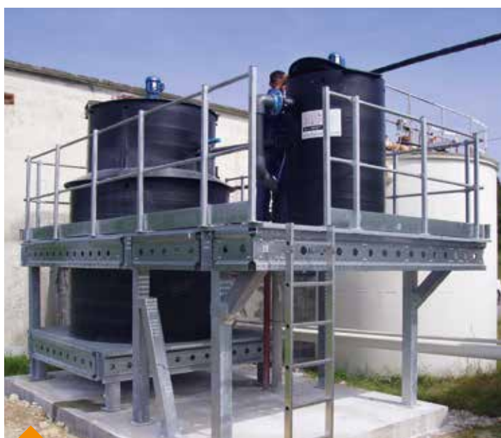
Plateforme de maintenance.
